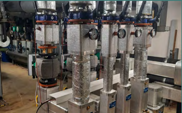
Abbildung 22: Die neue Fernwärmeübergabestation für das Gebäude 240
