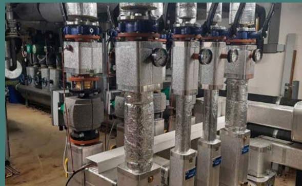
Abbildung 22: Die neue Fernwärmeübergabestation für das Gebäude 240
