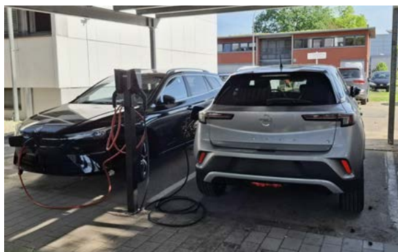
Abbildung 20: Die Ladestation von FIZ Karlsruhe wird gut genutzt.
